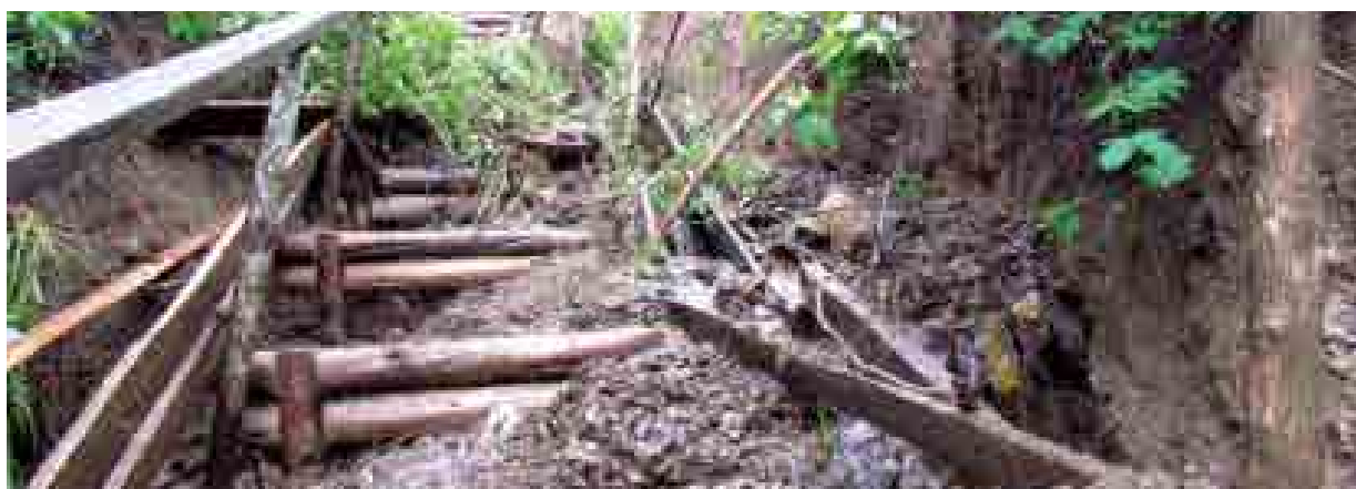
Daños escaleras Isla De La Plata
